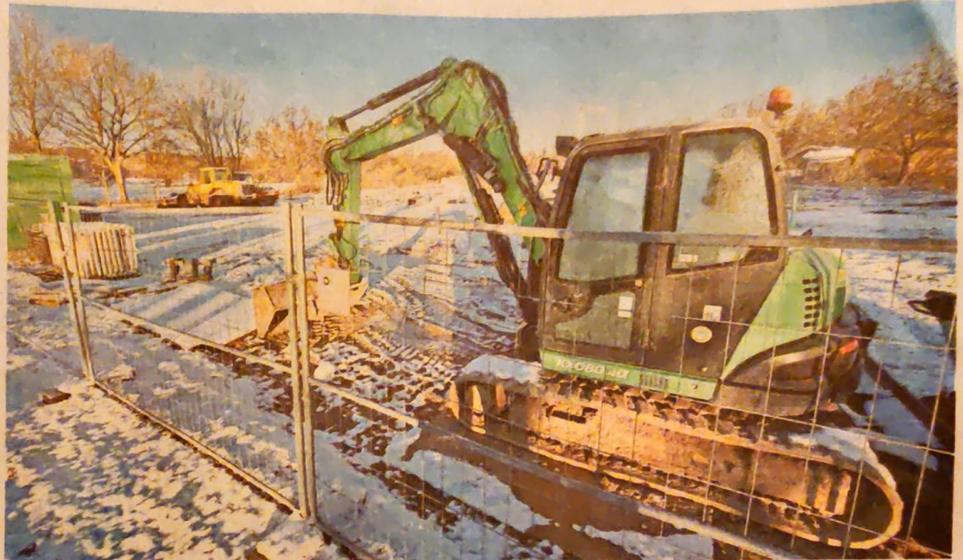
Auf dem Festplatz an der Kerntangente werden nicht nur wegen des Wetters die Bauarbeiten für die Interimslösung für die Wisser-Schule gestoppt. Ist das geplante Containerdorf überhaupt noch nötig?
